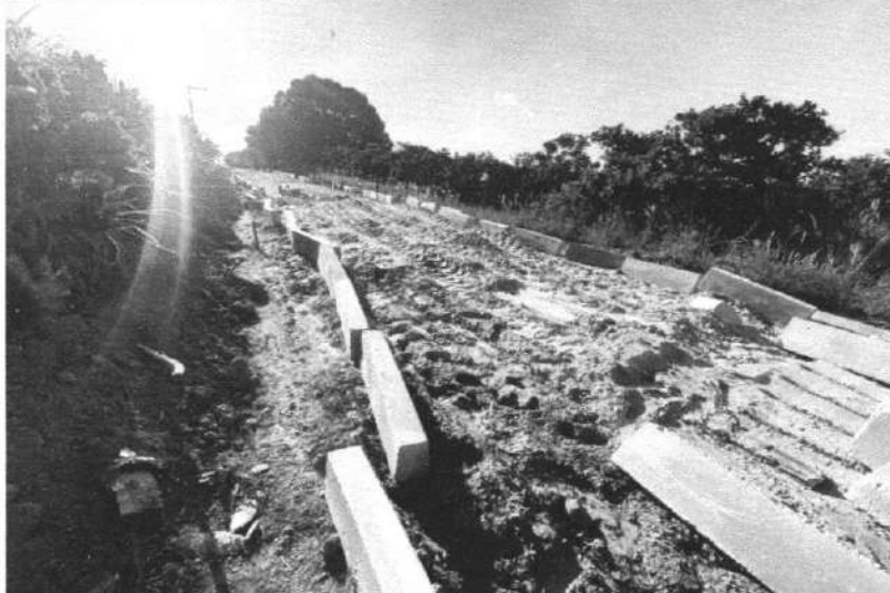
ATERRO COM AREIA FINA, COMPACTADO MECANICAMENTE, INCLUSIVE AQUISIÇÃO EM DEPÓSITO DE MATERIAL | TRANSPORTE COM CAMINHÃO BASCULANTE DE 14 M 3
